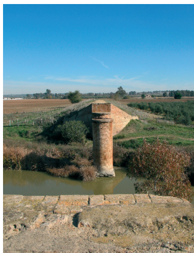
▲ Vistas desde el Puente ferroviario en ruinas sobre el río Guadiamar. Views of the Guadiamar river from the train bridge in ruins.
